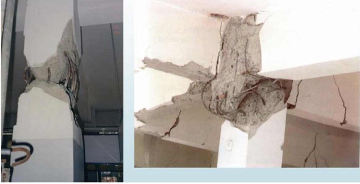
Şekil 4. Kolonlarda Burulma Hasarı.
